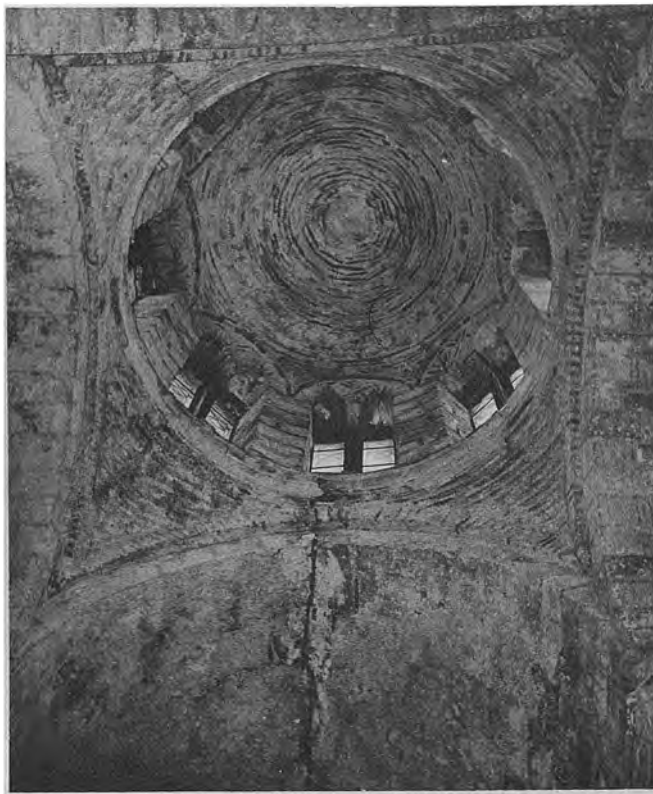
Μονή Ὁσίου Λουκᾶ. Ναός Παναγίας : α - β. Λεπτομέρεια τοῦ ἐσωτερικοῦ τοῦ ναοῦ πρὸ καὶ μετὰ τὰς ἐργασίας
