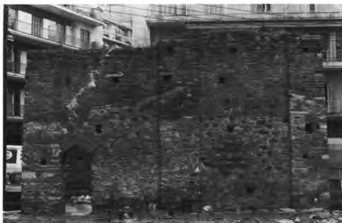
Θεσσαλονίκη: α-β) Ναός Νέας Παναγίας. Δυτική πλευρά και κόγχη Ιερού Βήματος μετά το σεισμό, γ-δ) Ο Πυλώνας των Αγίων Αποστόλων μετά το σεισμό και μετά τη στερέωση.
