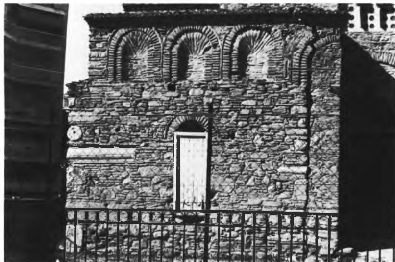
Θεσσαλονίκη: α-β) Αγία Σοφία. Ρηγματώσεις στην κιονοστοιχία της δυτικής κεραίας και στο κωδωνοστάσιο, γ) Άγιος Παντελεήμων. Βόρειο παρεκκλήσι μετά το σεισμό.
