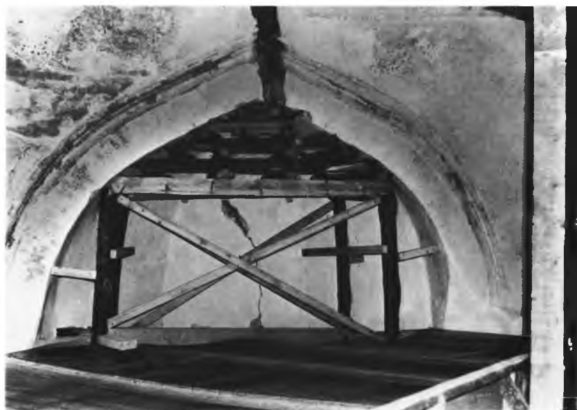
Θεσσαλονίκη, Λουτρά Γιαουντί Χαμάμ: α-β) Ρηγματώσεις της βόρειας πλευράς του δυτικού και του ανατολικού τρούλου, αντίστοιχα, γ) Υποστήλωση βορειοδυτικής κόγχης δυτικού τρούλου.
